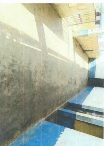
Foto 4: El piso de este pasillo será remodelado por piso cerámico.
